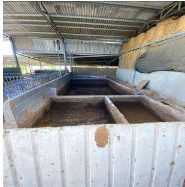
Hình ảnh các ngăn xử lý nước thải tại bể số 2
