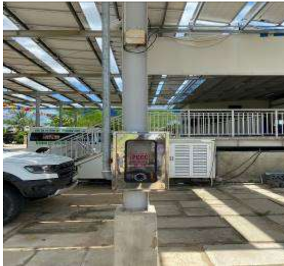
Hộp PCCC + Lãng phun nước tại Dự án
